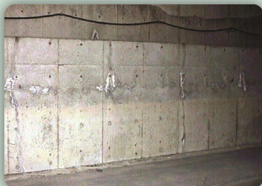
壁に発生したひび割れ
